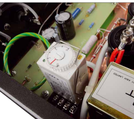
Dieses Relais erledigt die Einschaltverzögerung
